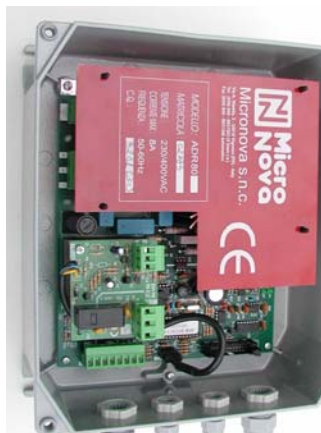
1. Beispiel: Adrex auf Trafo montiert
